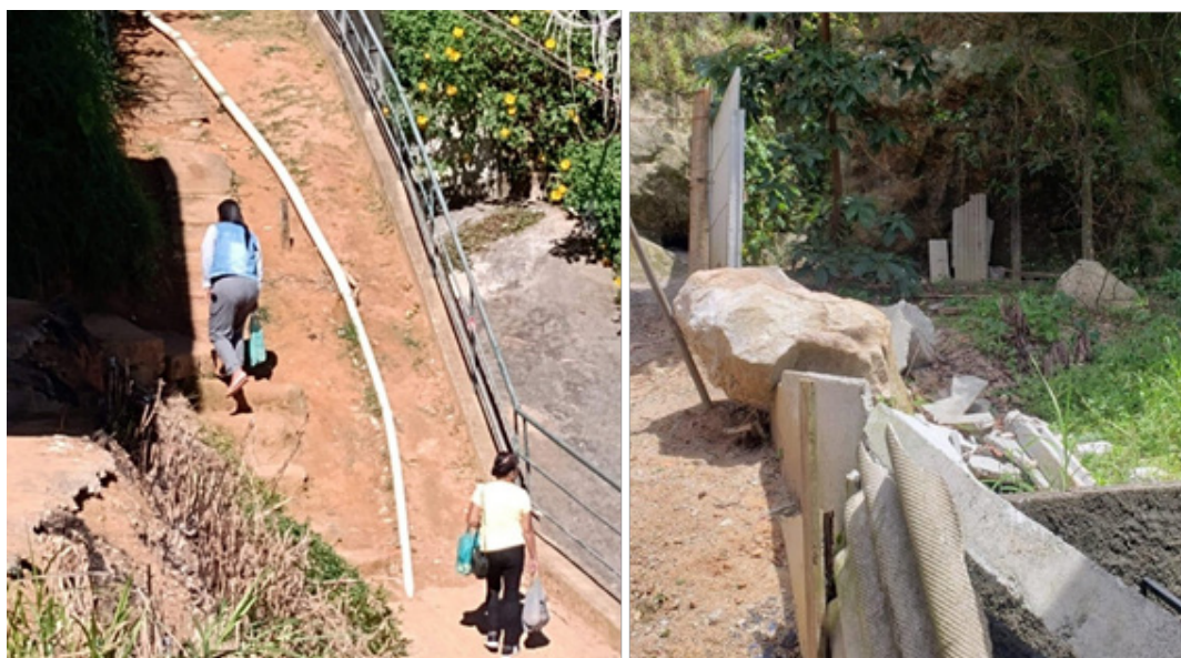
Figura 2 - Escadaria sem calçamento ou apoios e escombros de deslizamentos anteriores. Fonte: Acervo próprio.
