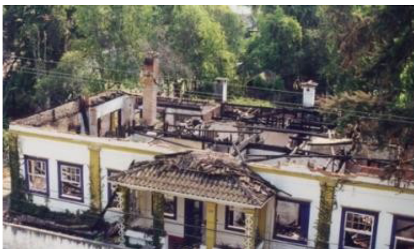
Figura 5: Vista aérea da edificação após o incêndio
